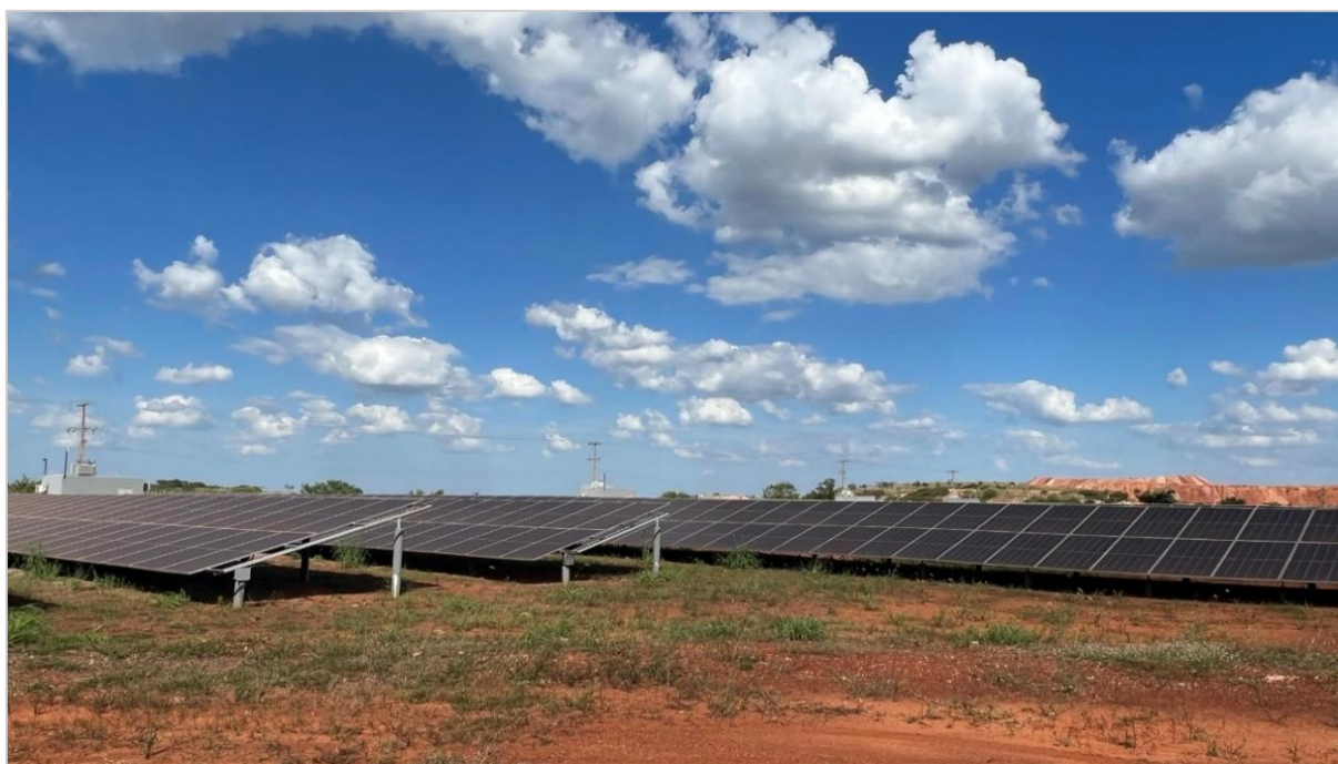
Figura 46. Painéis solares para produção de energia
